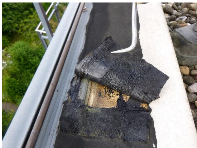
Foto 13 Dakrandafwerking met aluminium daktrim is onvoldoende waterdicht uitgevoerd met EPDM-stroken.
