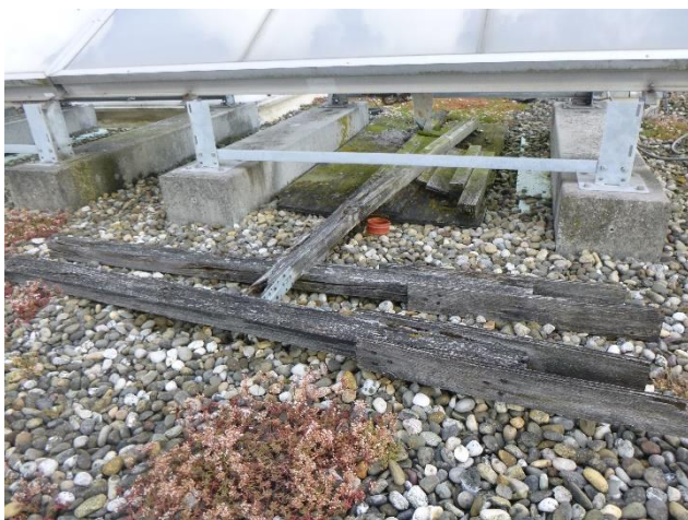
Foto 19 Vervuiling van restanten houten balken en houten plaat aanwezig op het dakvlak.
