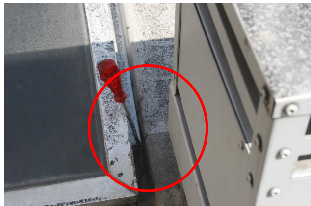
Foto 26 Inwateringspunt bovenzijde PMMA-coating bij aansluiting zonneboiler.
