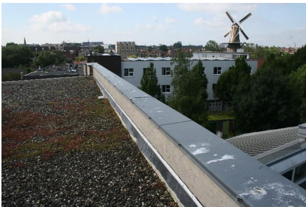
Foto 9 Aluminium afdekkappen zijn onvoldoende op afschot aangebracht richting dakvlak.
