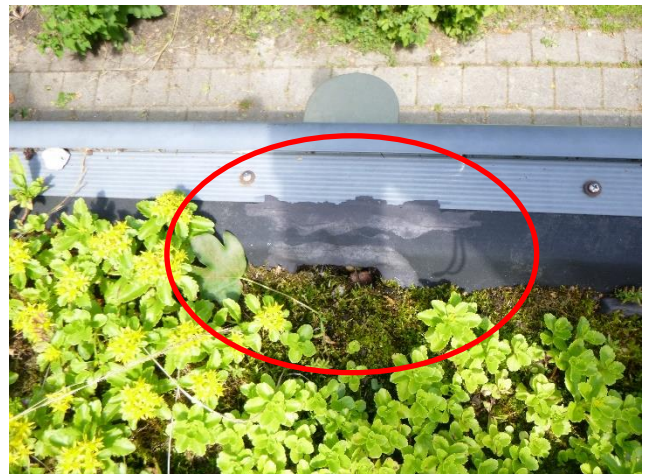
Foto 34 Dakrandafwerking met aluminium daktrim is niet ingewerkt, bij de hemelwaterafvoeren is de trim afgekit.
