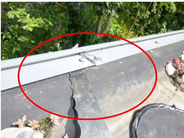
Foto 35 Aluminium daktrim is onvoldoende vastgezet en niet in kit geweld. Koppelnaden zijn voorzien van een bitumenrups.
