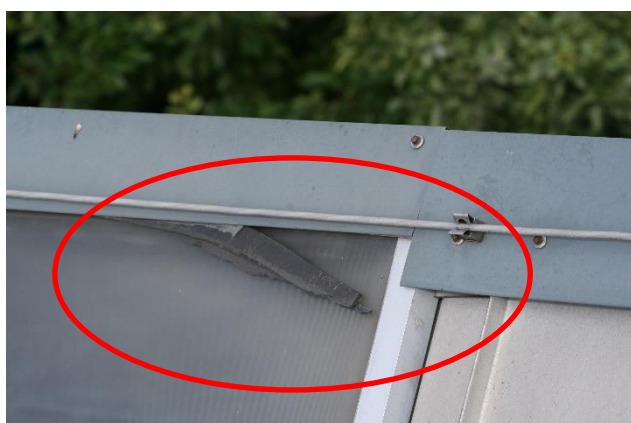
Foto 29 Diverse rubbers zijn bij de zonneboilers onder de stalen afdekkappen uitgezakt.
