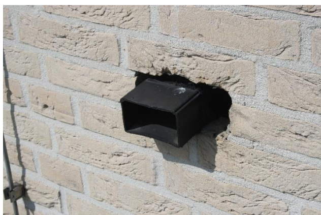
Foto 17 Noodafvoeren zijn aan de buitengevel niet rondom afgesaald met een kit.
