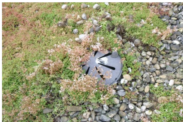
Foto 16 Hemelwaterafvoer redelijk vervuild door plantengroei.
