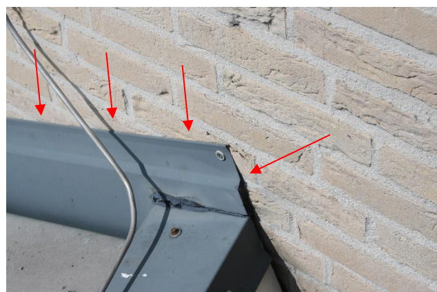
Foto 28 Bovenzijde muuraansluiting is niet afgedicht met slabben of kit
