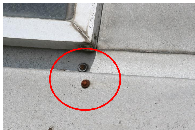
Foto 30 Groot gedeelte van de bevestigigers is gecorrodeerd.
