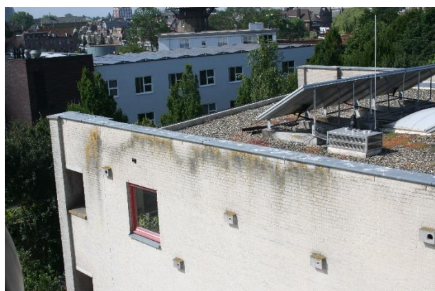
Foto 18 Vervuiling door vocht op de gevel door verkeerd afschot van de aluminium afdekkap.
