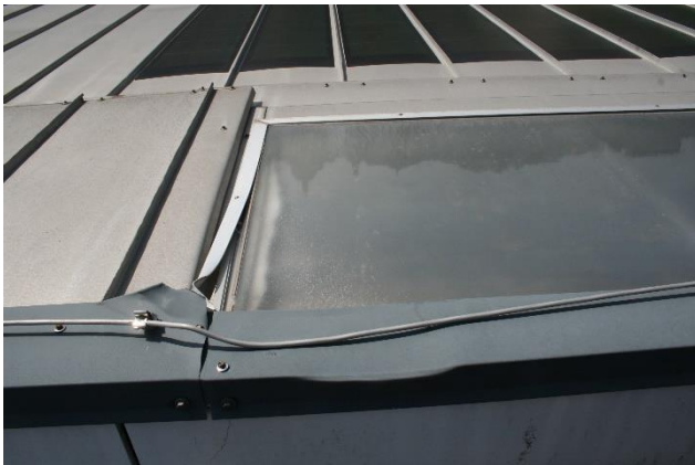
Foto 31 Beschadigde dakrand en profiel zonneboiler aan de hoge zijde dakvlak.
