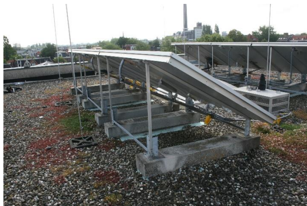
Foto 2 Overzicht op betonblokken geplaatste zonneboilers.
