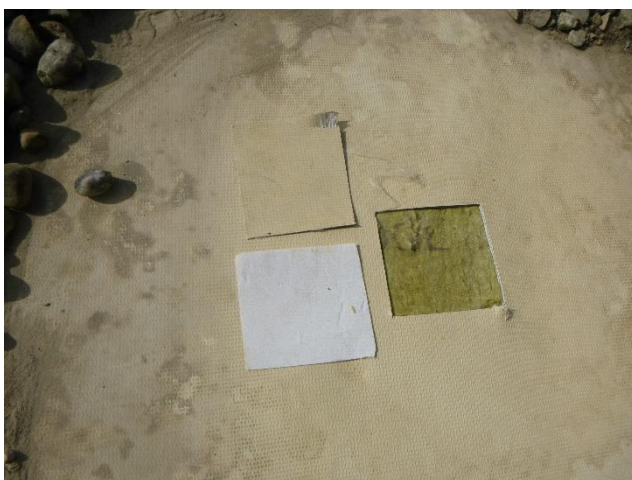
Foto 3 Bij insnijding TPO-dakbanen, glasvlies en steenwolisolatie.
