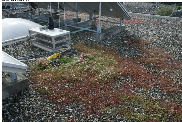
Foto 15 Redelijke vervuiling in het dakgrind door plantengroei.
