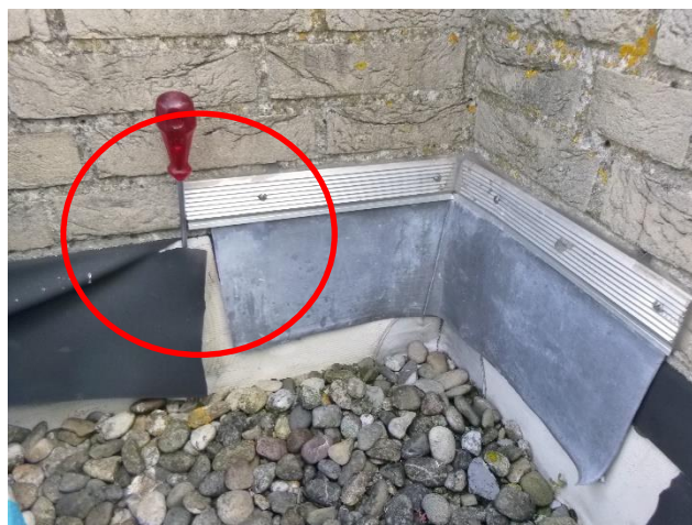
Foto 6 Op diverse plaatsen ontbreekt de afwerking boven de randstrook. Knelstrippen, zie ook foto 5.
