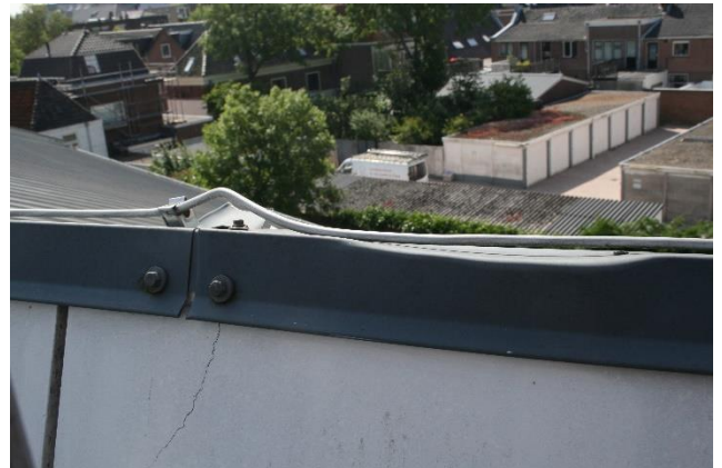
Foto 32 Beschadigde dakrand en boeiboord aan de hoge zijde dakvlak.
