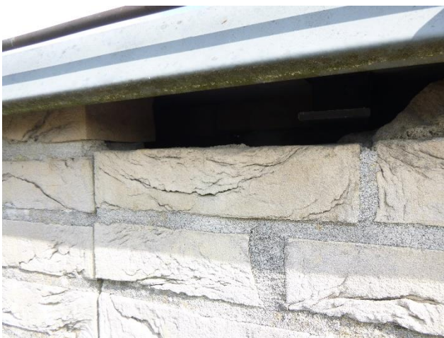
Foto 11 Diverse gevelopeningen bij staalprofielen in de spouw zijn niet wind-/waterdicht afgewerkt.
